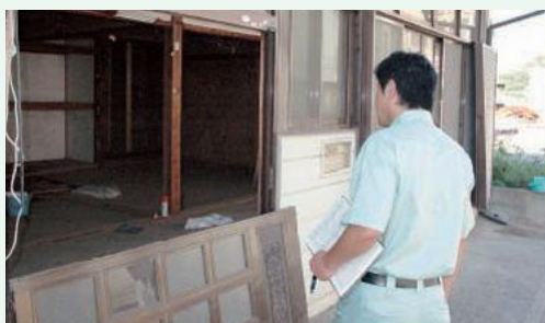
津波で罹災した組合員宅の損害調査
